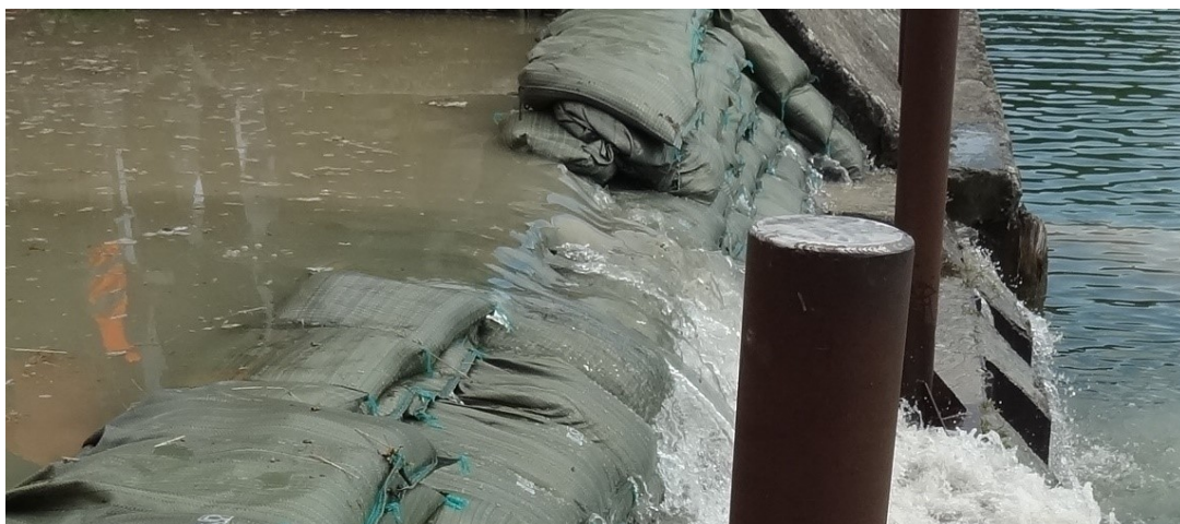
Abb. 41: Überströmter Sandsackdamm (Herbert Götschmann, BABS).
