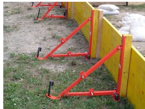
Sicherung mit verstellbaren Abschälböcken aus dem Bausektor
