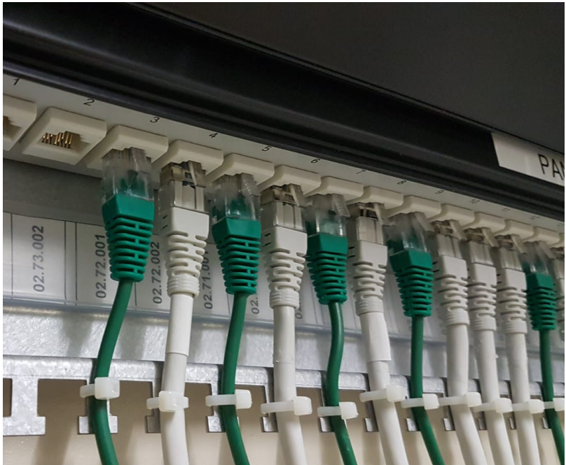
Abb 46: Verteiler mit den nummerierten Anschlüssen.
