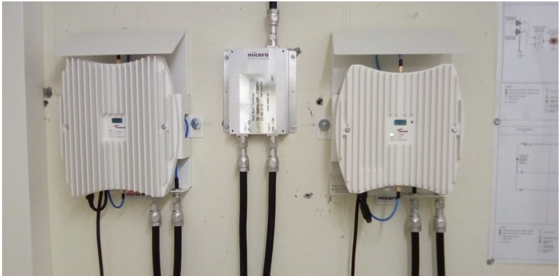
Abb. 35: Beispiel eines Polycom-Repeater (links), einer Frequenzweiche (Mitte) und eines Mobilfunk-Repeater (rechts).
