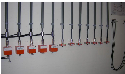
Abb. 34: Funkinstallationen im Telematikzentrum mit Verbindungskabel (rechts).
